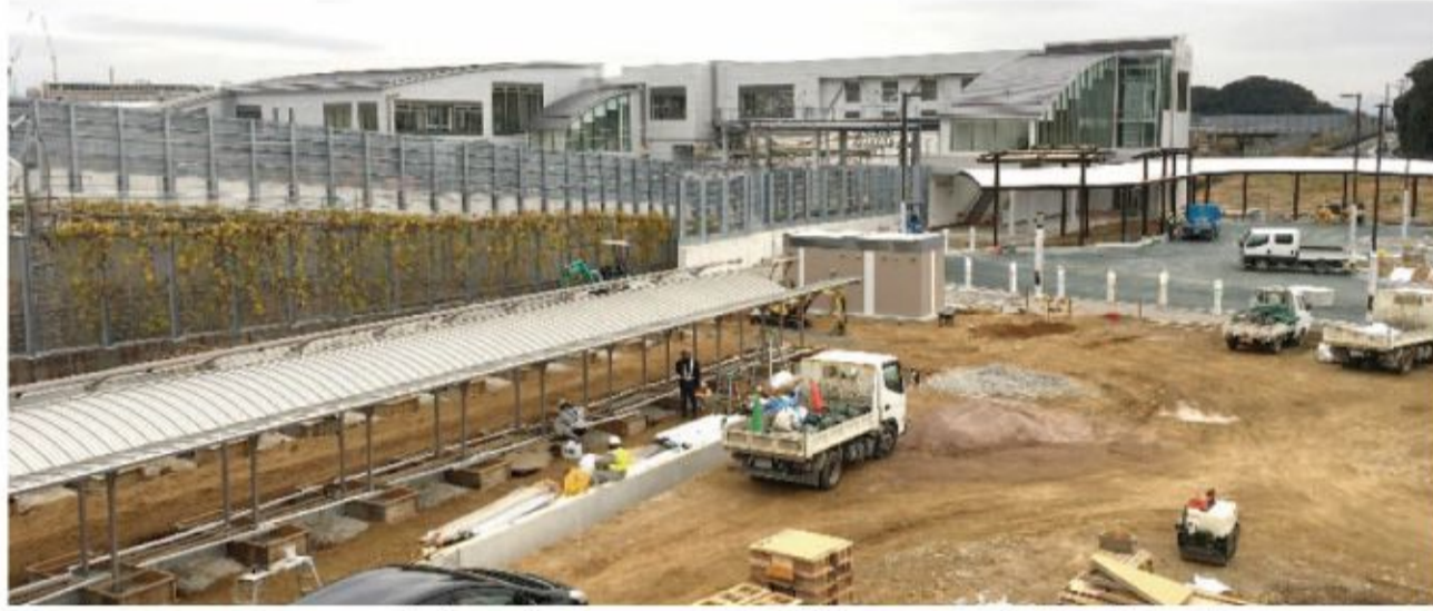
12月19日の新駅南口工事の様子 自転車置場、駅前ロータリーの工事が急ピッチで進められている
